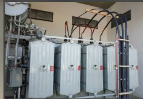
NUEVO TRANSFORMADOR 33/13.2kV de 10MVA
