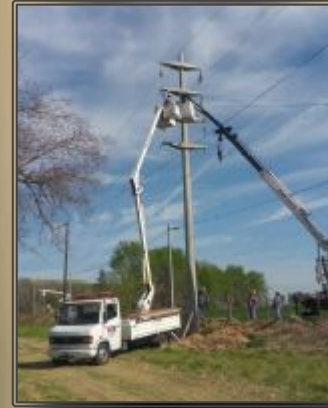
NUEVA LÍNEA DOBLE TERNA DE MEDIA TENSIÓN
